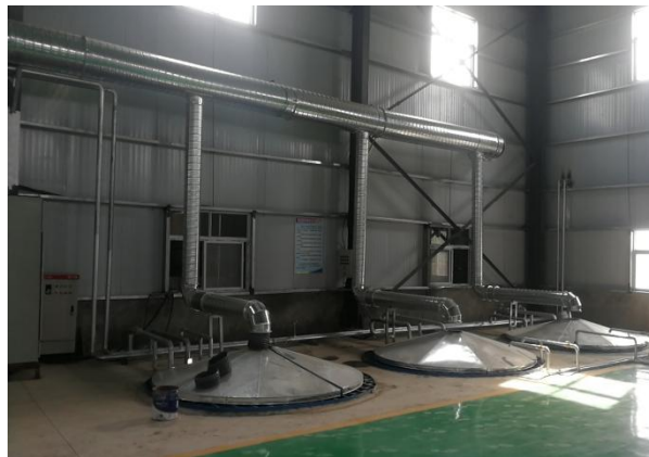
废气集气管道
